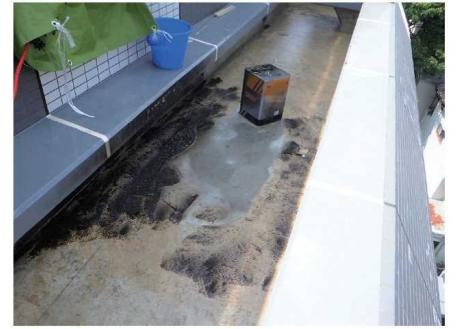
焼損した陸屋根の状況
