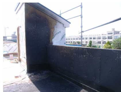
ルーフバルコニーの焼損状況
