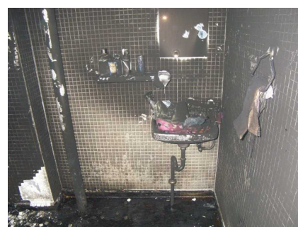
浴室の焼損状況
